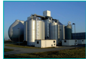
Reaktoren für die Biogasproduktion und -reinigung in einer Kläranlage
